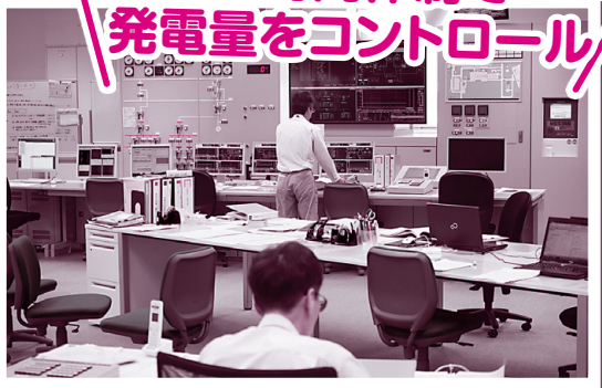
発電所を24時間休みなく見守り、運転をコントロールする中央制御室。つくられている電気の量などもつねに表示され、中央給電指令所からの指令もここに送られてくる。
