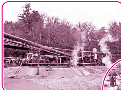
地下からエネルギーを取り出す生産井
