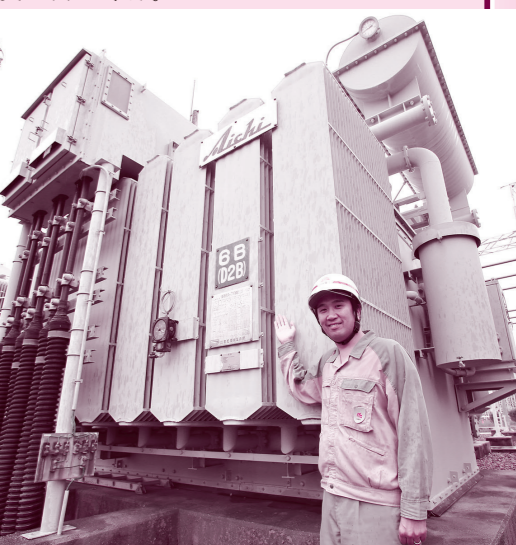
これが電圧を変えるための変電所の変圧器だ。中には油で絶縁されたコイルが入っている。実はこの変圧器、ちょうどこれからオーバーホール(分解点検修理)に入るそうで、中身を全部バラバラにしてメンテナンスするゾ。
