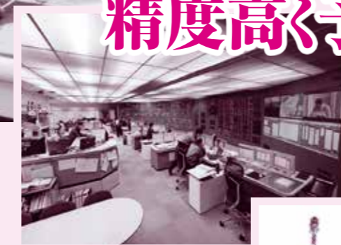
中央給電指令所の全体像。給電盤を正面に、指令台が並ぶ。左側の一段高いところにいる人が、チームのまとめ役の当直長だ。
