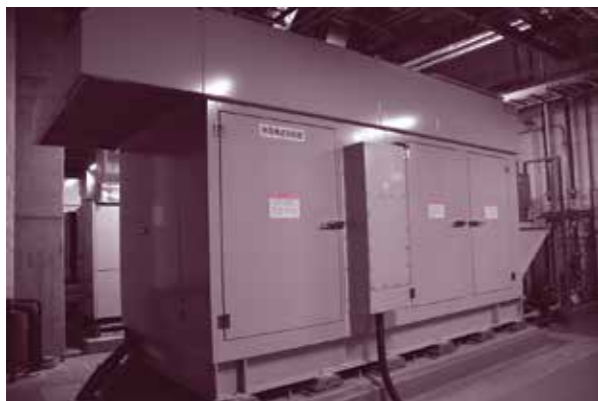
コージェネレーションシステムは都市ガスを燃料にしたエンジン式の発電機。電気をつくって余った熱のエネルギーをむだにせず、暖房などに再利用している。
