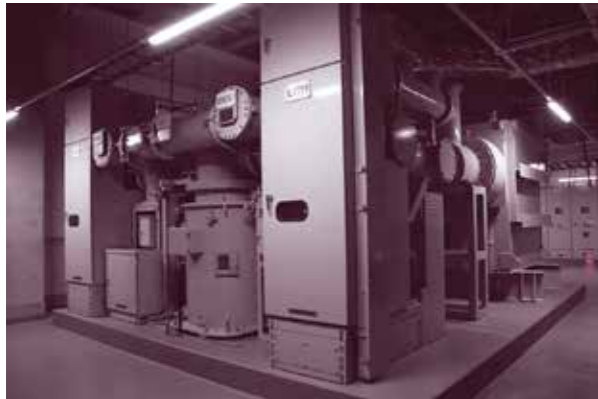
地下のケーブルを通ってきた電気は、この特高変圧器で電圧を下げてから、それぞれの場所に届けられる。万一に備えて回線は2つある。
