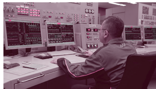
発電所の規模は大きいですが、建物の中で作業をしている人の姿は意外と少ない。ボイラーの様子を監視したり、発電機の出力を調整したりする作業は、離れた所にある中央制御室で行われる。(写真提供／株式会社 JERA)
