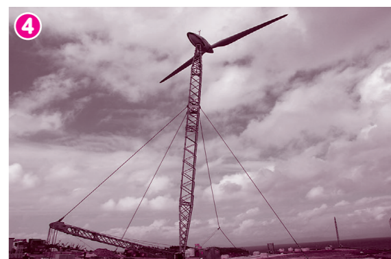
可倒式風車のタワーの鉄塔はL字型になっていて、支えているワイヤーを巻き上げたり戻したりすることで、本体が倒れたり立ち上がったりますくみだ。作業にかかる時間は約45分。(写真提供／沖縄電力株式会社)
