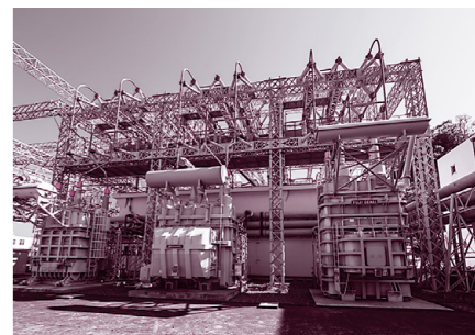
3台並んだ高圧短絡変圧器。いろいろな試験の必要に応じて組み合わせを変えた回路を構成し、電圧を調整する。
