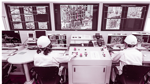
短絡試験自動制御・コンピューター計測システム。ここから短絡試験や発電機の制御、試験の計測を行う。
